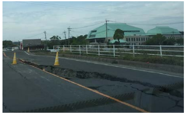
道路には亀裂が入り、交通網を寸断している
